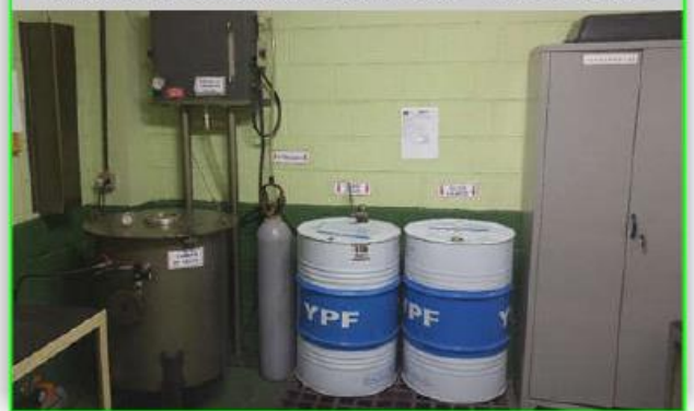
CÂMARA DE AQUECIMENTO - NITROGÊNIO - OLÉO ISOLANTE
